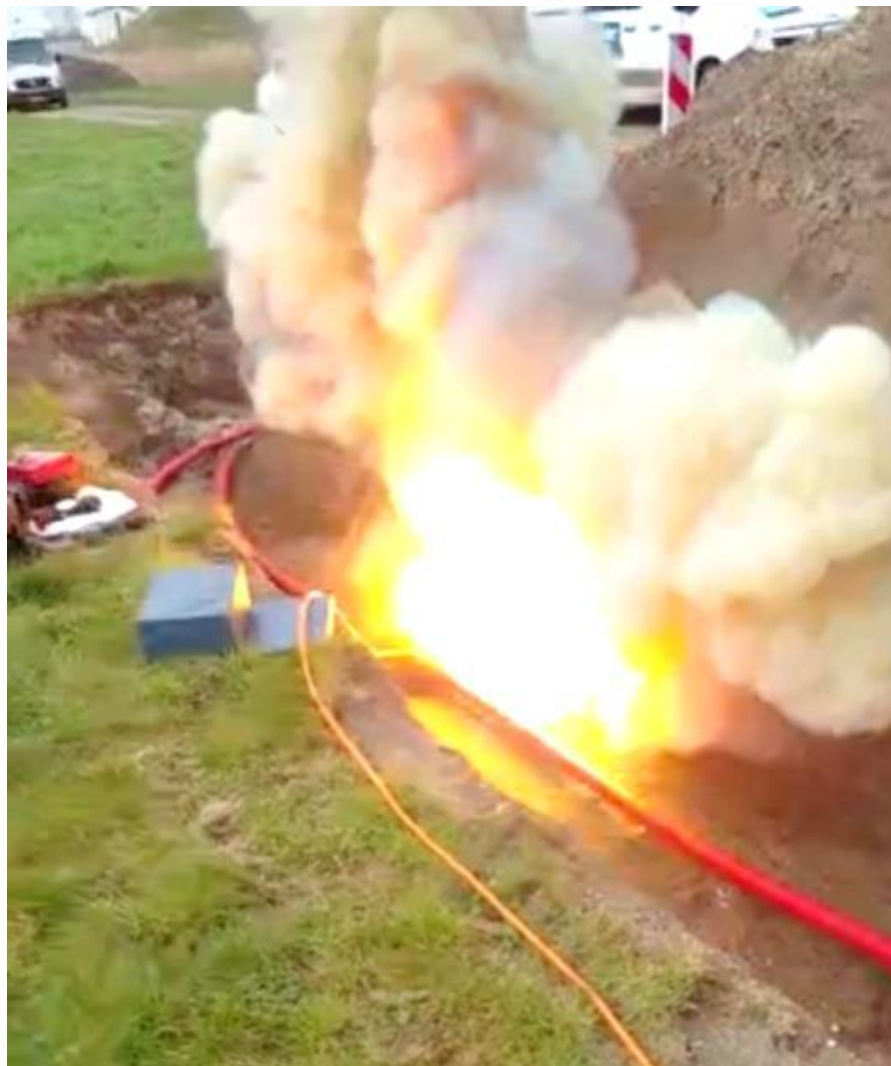
Vlamboog als gevolg van het knippen (op afstand) van een onder spanning staande kabel.
