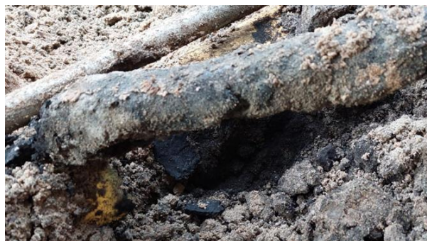
Foto's: Aangetaste gasleidingen en -componenten, waarbij zoutzuurgas is vrijgekomen
