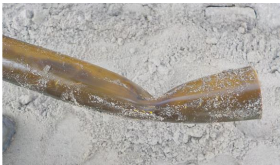
Foto 1: gebogen gasleiding die door de kracht van het vallende zand om een stalen leiding knikte
