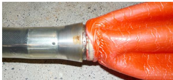
Foto's: gaslek en losgekomen aansluiting bij inspectie
