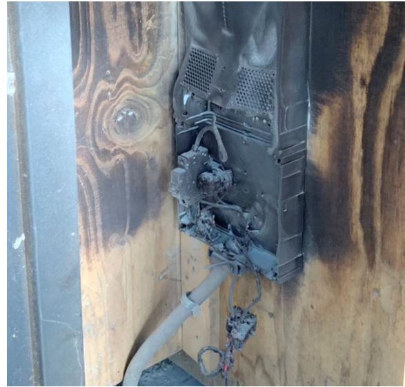
Foto: verbrande meterkast na incident
