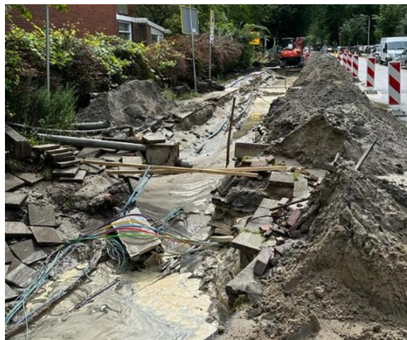
Foto's: gas- en waterlekage in openliggende sleuven
