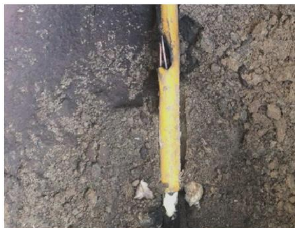
Foto 2: voorbeeld verkeerd gebruik mantelbuis
