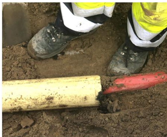
Foto 1: voorbeeld verkeerd gebruik mantelbuis
