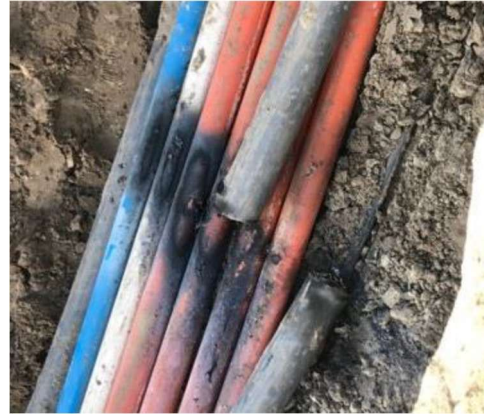
Foto: verkeerde kabel onder spanning geknipt
