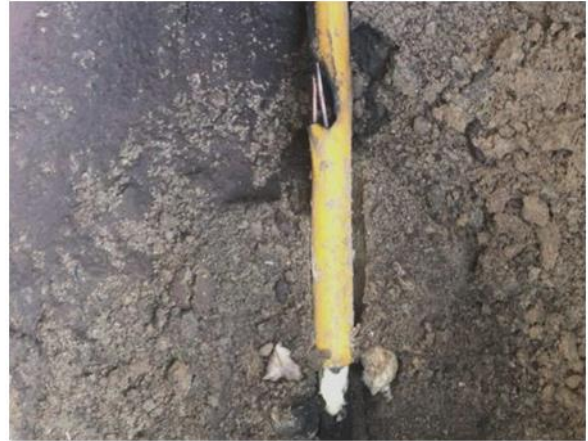
Foto 2: voorbeeld verkeerd gebruik mantelbuis
