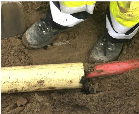
Foto 1: voorbeeld verkeerd gebruik mantelbuis
