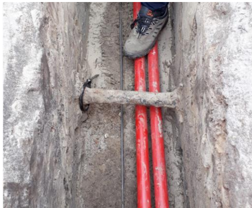
Foto 1: aan onderzijde beschadigde MS-kabel
