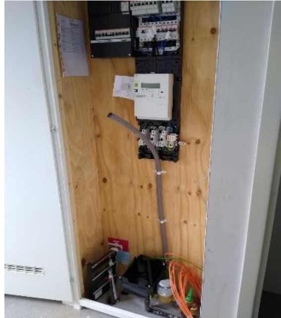
Foto 1: loshangende kabel meterkast
