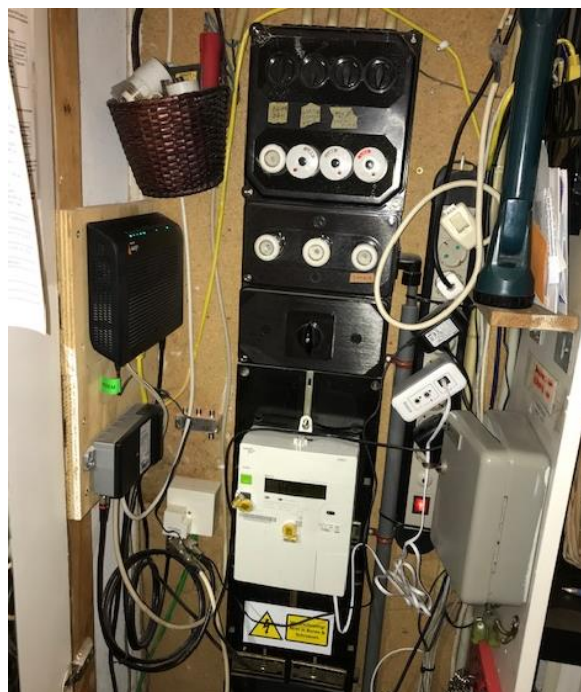
Foto 1: voorbeeld van een meterkast
