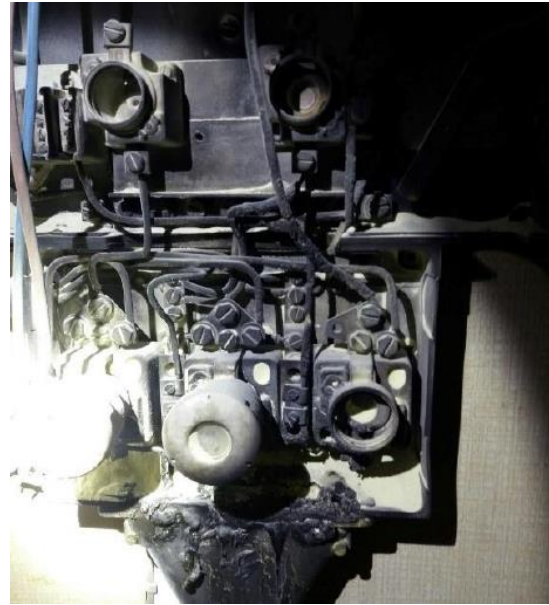
Foto 2: uitgebrande aansluitkast (voorbeeld)
