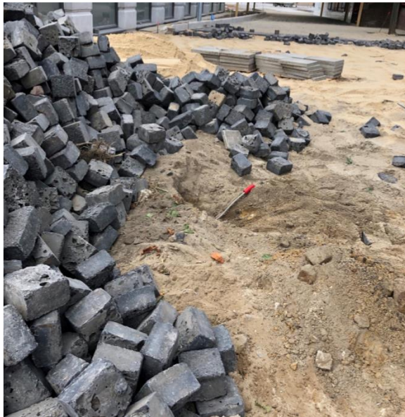
Foto 1: berg stenen rondom beschadigde kabel
