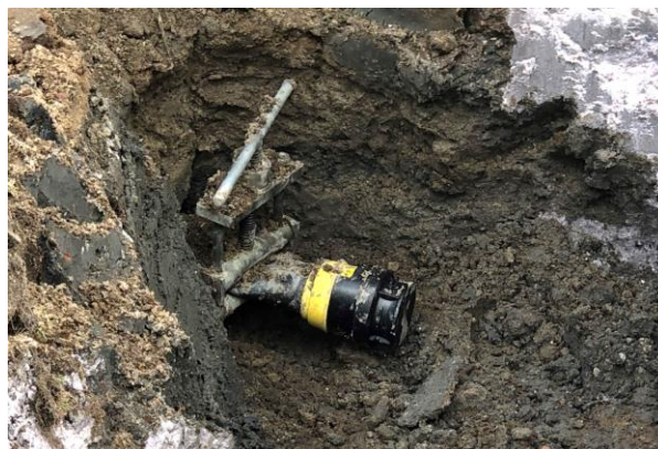
Foto 1: te laat geplaatste knevel op gasaansluitleiding
