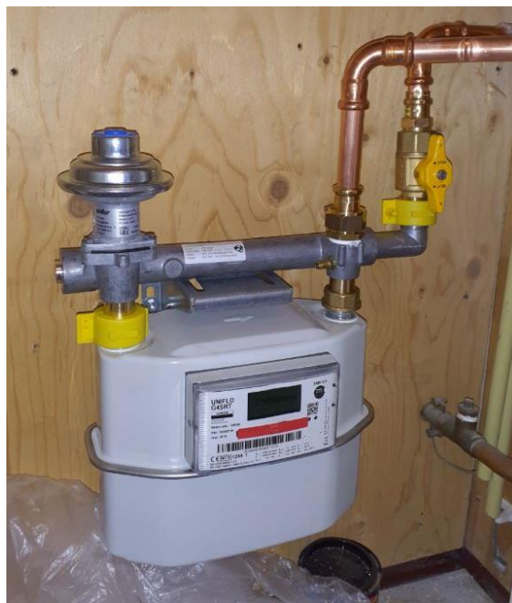
Foto: Voorbeeld van meteropstelling
