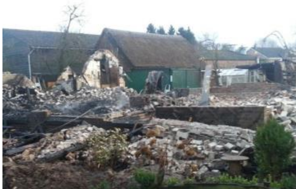
Foto: voorbeeld van beschadigde woning na gasexplosie
