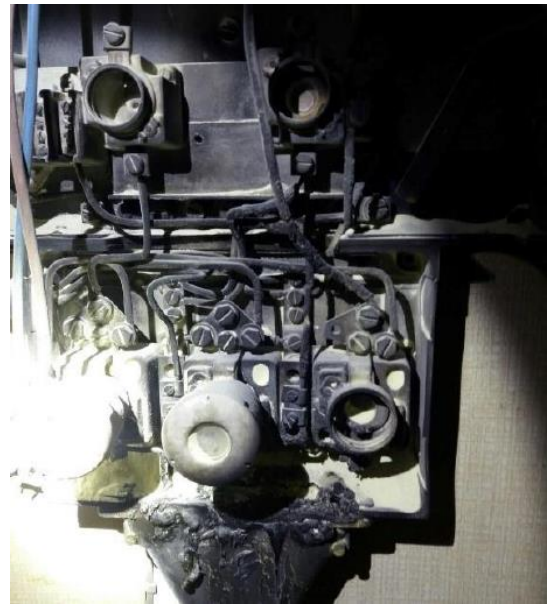
Foto 1: Uitgebrande aansluitkast (voorbeeld)
