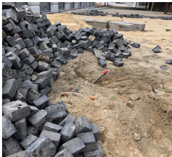
Foto 1: berg stenen rondom beschadigde kabel
