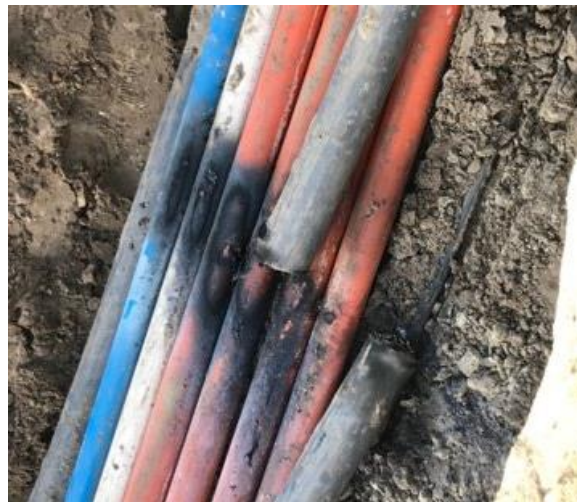
Foto: kabel onder spanning geknipt
