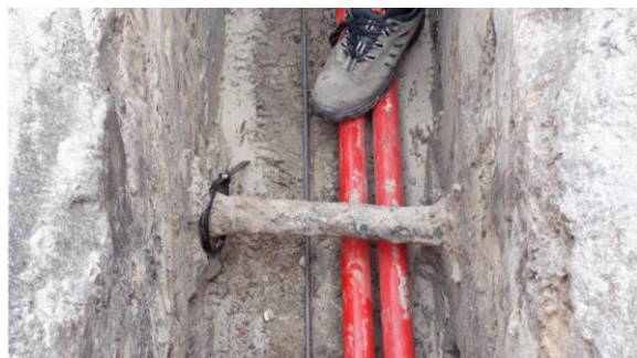
Foto 1: aan onderzijde beschadigde middenspanningskabel
