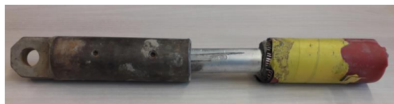
Foto 2: Kabeluiteinde 1 x 630 Al met losgeschoten trekkop
