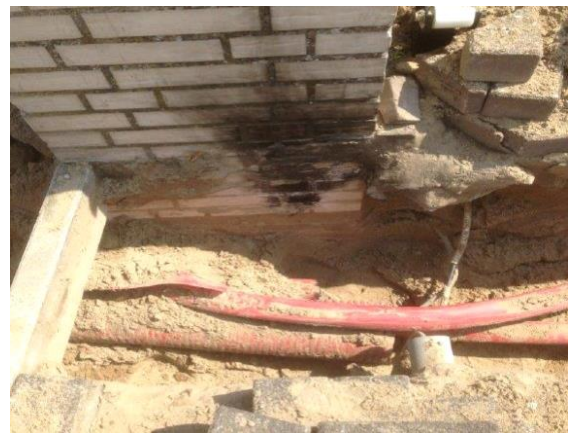
Figuur 1: Ligging kabels na incident met afdruk vlamboog
